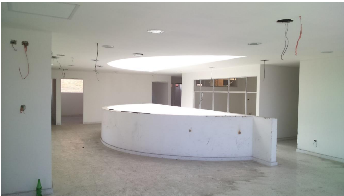
Fotografía 5. Se observan acabados en estado de deterioro, instalaciones eléctricas no terminadas y sin protección.
